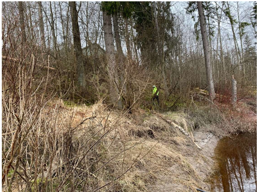
Slänten nedifrån, pågående erosion
