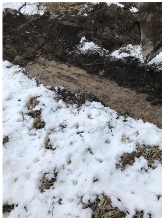
Figur 14 Provgrop ÅF1806. Här syns rester av rivningsmaterial som brädor mm.
