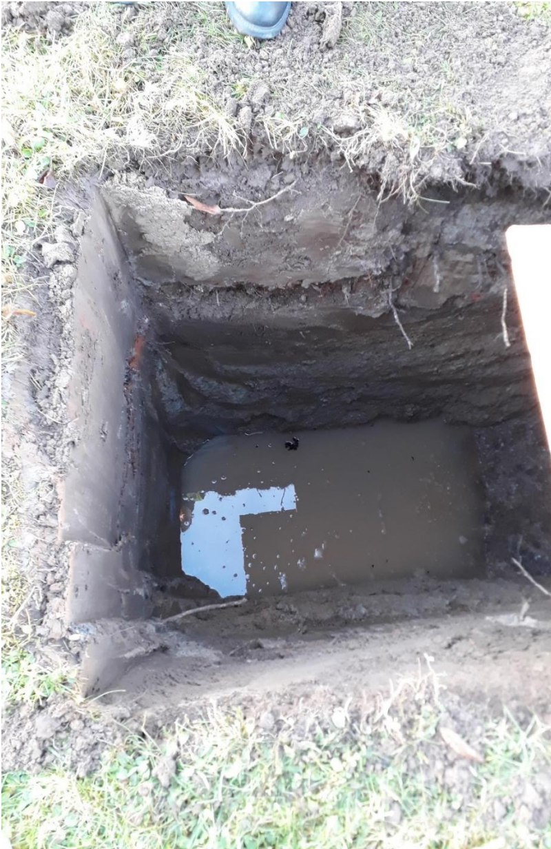
Inspektion av provgrop dag 3, 2019-12-19. Vatten i provgrop på ett djup av cirka 2 meter under markytan, se bild nedan. Bedömning har ej gjorts huruvida det är regnvatten via inläckage eller grundvatten.
