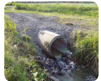
Exempel på öppna diken och trumma under grusad väg/överfart.
