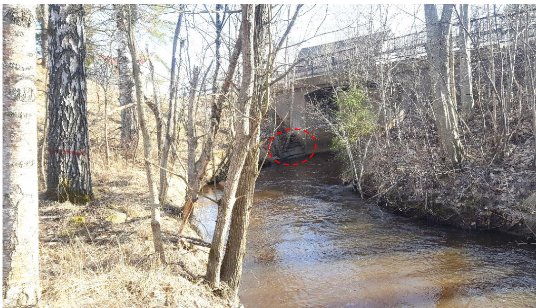
Figur 5-3. Foto taget i östlig riktning inom området, i anslutning till Lerälven. Erosionsskydd vid vägbro är inringat med rött.
