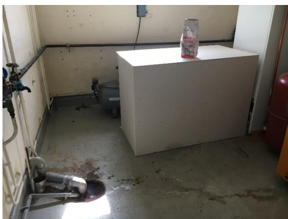
Figur 7. Avlopp i pannrummet
