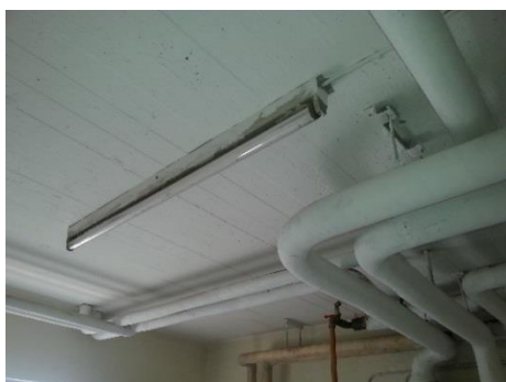
Figur 10. Rörböjar och ändavslut (mot ventiler) på rörisolering innehåller troligtvis asbest. I huvudsak på grövre dimensioner av rör, så förekomsten kan vara begränsad till pannrummet.
