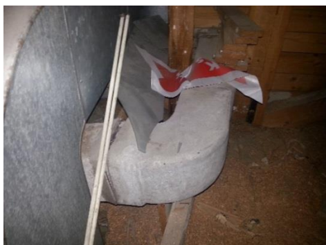
Figur 12. Ventilationskanaler av eternit förekommer. Bild tagen på vinden.
