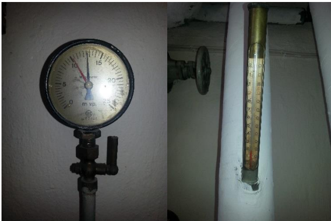
Figur 14. Manometer resp. termometer i pannrummet.
